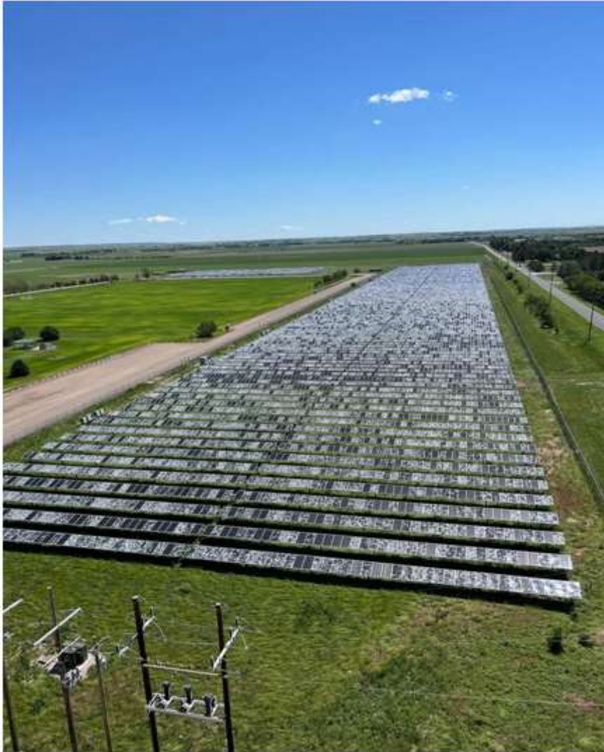
Slika 7. A baš i ne štite od tuče – Nebraska (14.000 panela, 5 Megawatta) uništila oluja sa jakom tučom
